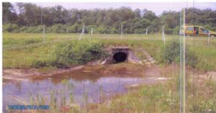
7.9 pav. 117,2 km varliagyvių užtvara ties esama vandens pralaida.
