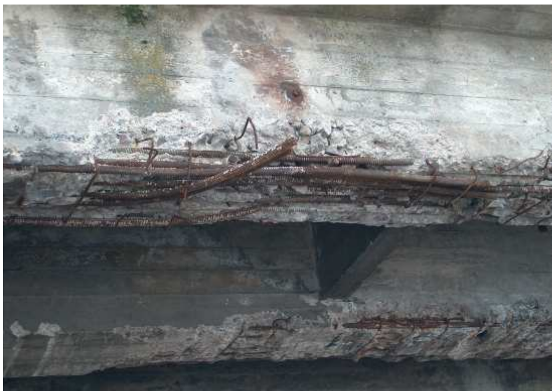
3.1.2.4 pav. Geležinkelio viadukas virš Liepų g. (matyti defektai)
