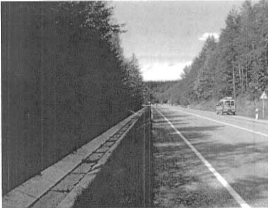
7.4.3.1 pav. 42,7 km. Betono latakas kelio kairėje pusėje (2008-05)
