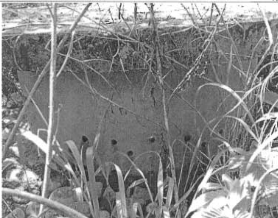
7.4.3.3. pav. 43,35 km, kelio kairė pusė. Iš sėsdintuvo nuotekų perteklius išteka per angas rentinio sienelėje (2008-05)
