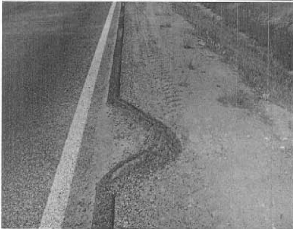
7.4.5.1 pav. 99,6 km, kelio dešinė pusė. Ties asfaltbetonio voleliu surinktos paviršinės nuotekos nuo kelio nuleidžiamos per po sankasa paklotus vamzdžius (2008-05)
