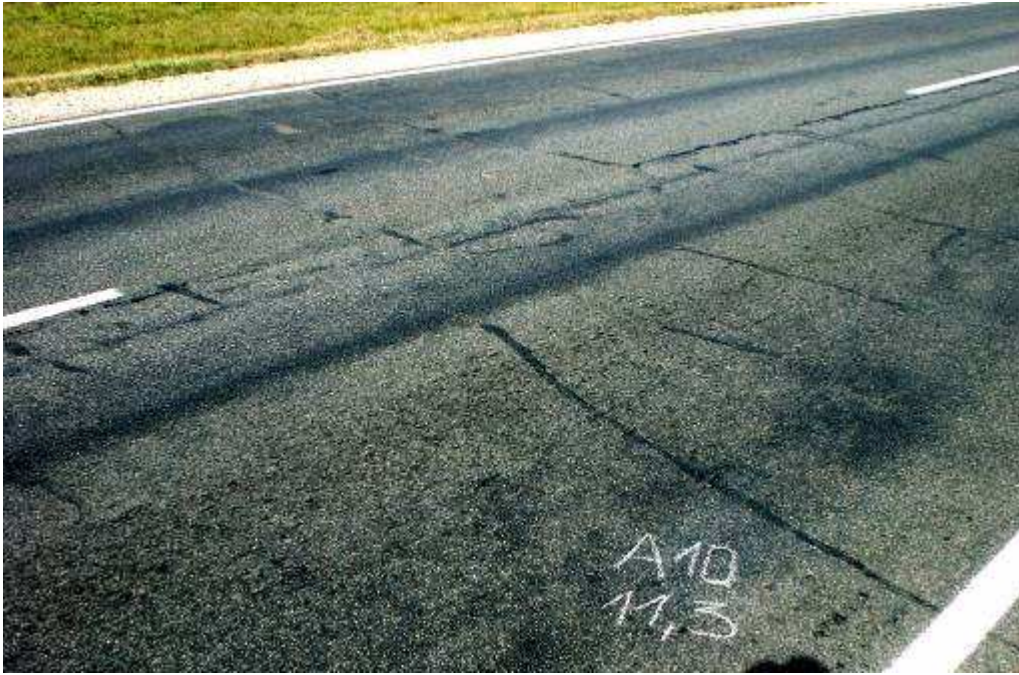
3.1.2.1 pav. A10 Panevėžys-Pasvalys-Ryga 11,3 kilometre kelio dangos defektai
