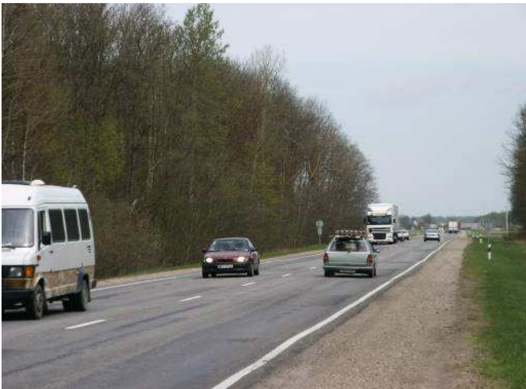
3.1.2.2 pav. A10 Panevėžys-Pasvalys-Ryga 9,8 kilometre kelio dangos defektai
