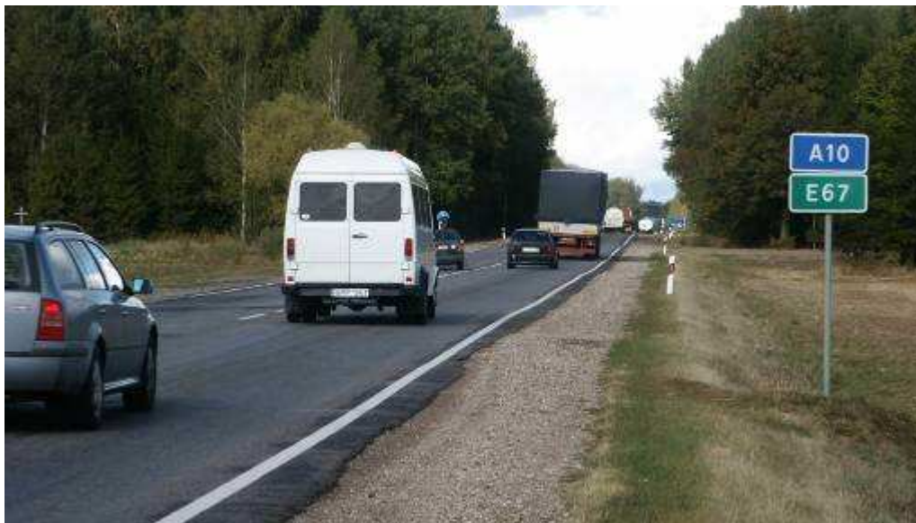
3.1.2.3 pav. A10 Panevėžys-Pasvalys-Ryga 34,5 kilometre kelio dangos defektai
