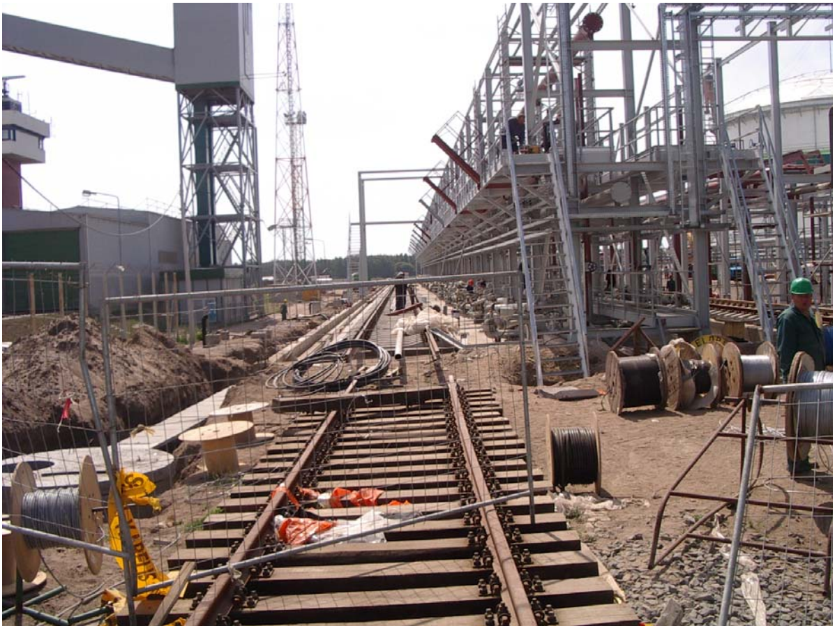
6 pav. Geležinkelio statyba prie krantinės Nr.3 esančiame sklype dar nebaigta, nors krantinė rekonstruota ir pritaikyta švartuoti didelio tonažo laivams 2001 metais
